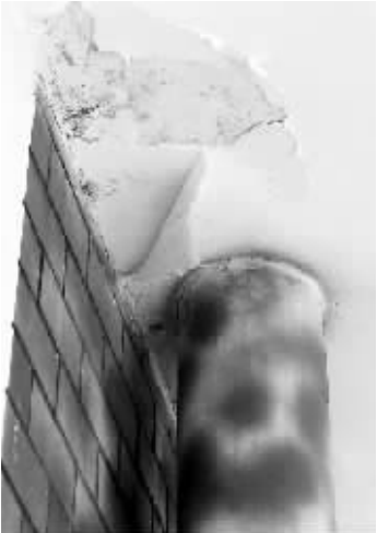
■ 新房尚未入住顶部粉饰已脱落
