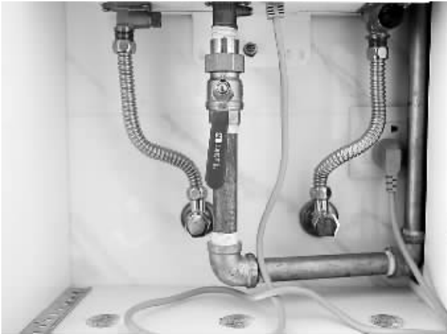
■ 厨房里的燃气管与电插座太近存安全隐患
