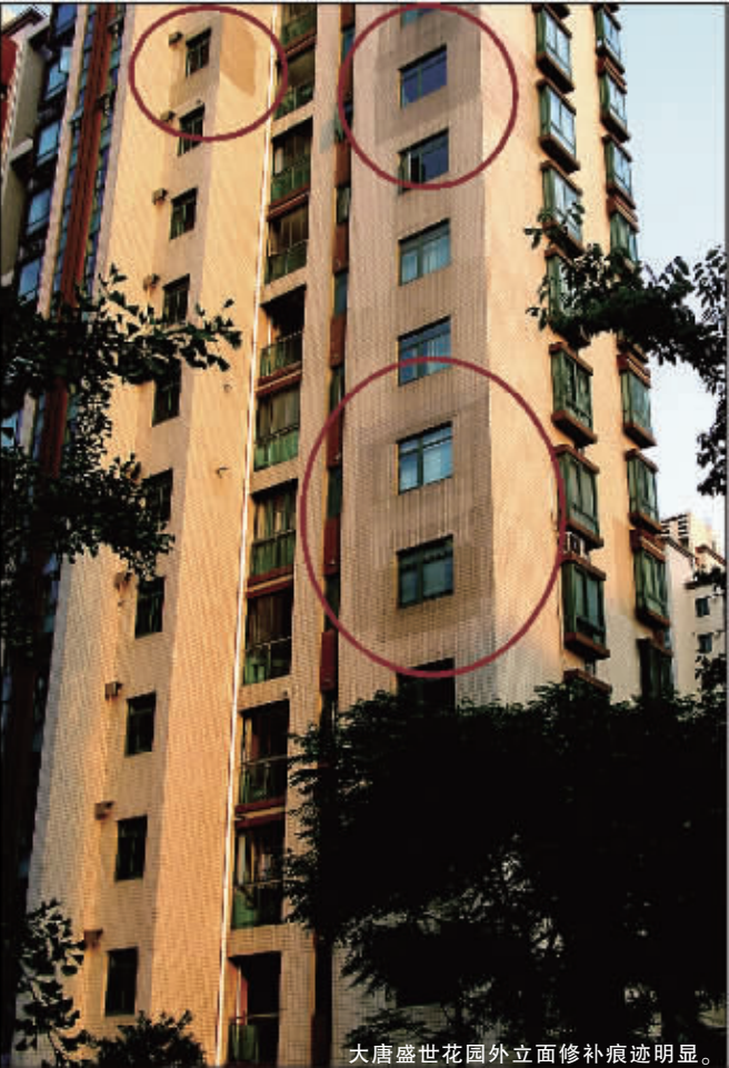
大唐盛世花园外立面修补痕迹明显。
