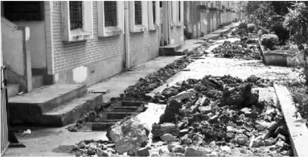
■ 上海奉贤区泰南苑被开挖的路面现状
