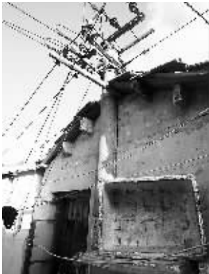
■ 违法建筑与电力设施“亲密接触”造成安全隐患 纪海鹰 摄
