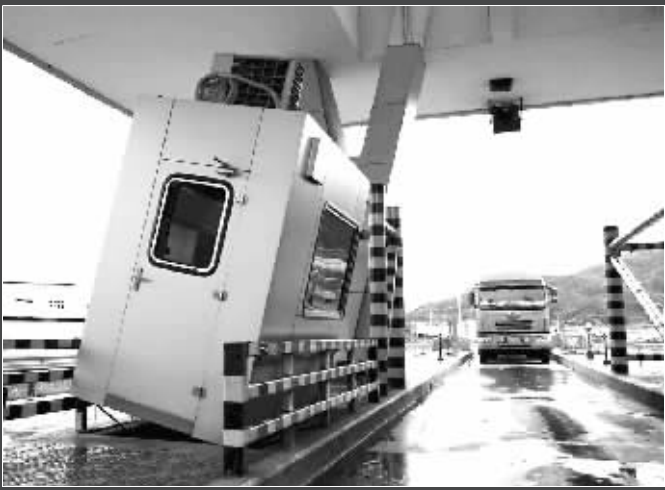
■今晨,沈海高速公路八尺门收费站的收费亭被台风刮歪
