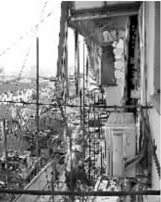
■ 603室的阳台全部坠落,只剩百叶窗和阳台顶 陈浩 摄
