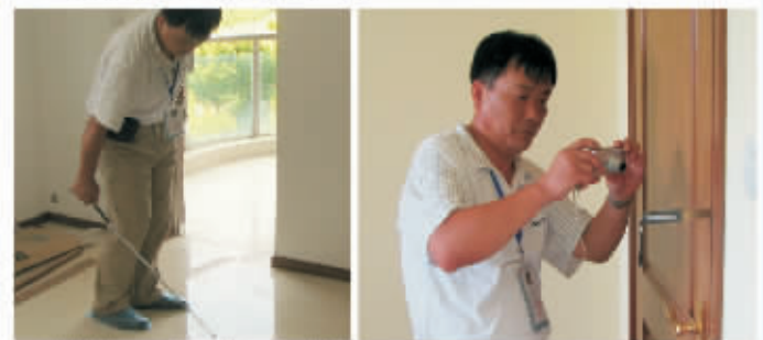
■每块地砖都要咚咚咚地检测过是否有空鼓 ■塞尺法检测出木门缝隙超标，立此存照
