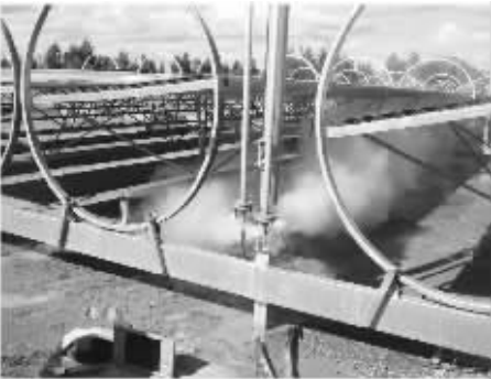
■ 太阳能热发电装置上的定日镜控制设备
