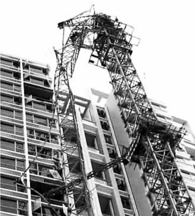
深圳工地一塔吊驾驶室坠落
