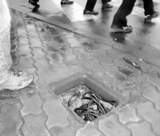
■ 窞井盖被盗,埋下安全隐患
