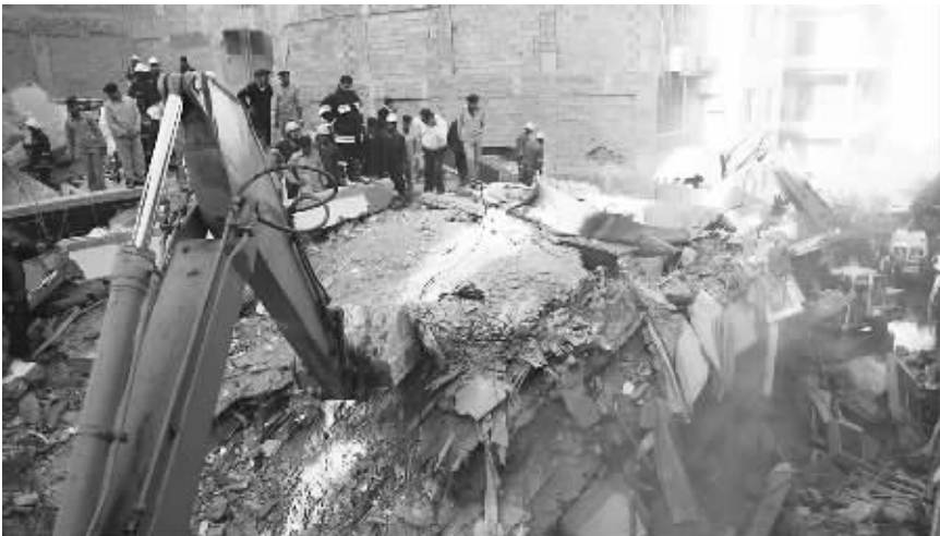
二十四日，救援人员清理坍塌楼房废墟。新华社发
