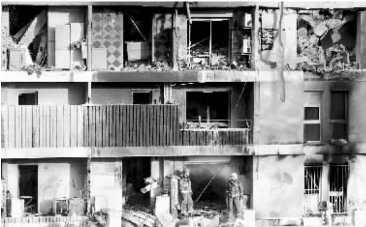
■ 12 月 3 日,西班牙消防人员正在检查煤气爆炸现场
