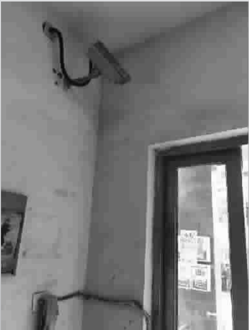
■ 虹梅景苑二街坊损坏的摄像头虚设、防盗门虚掩
