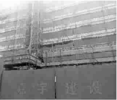
▲脚手架一搭5年无人管 ▼绿化带处堆满垃圾 黄卉 摄
