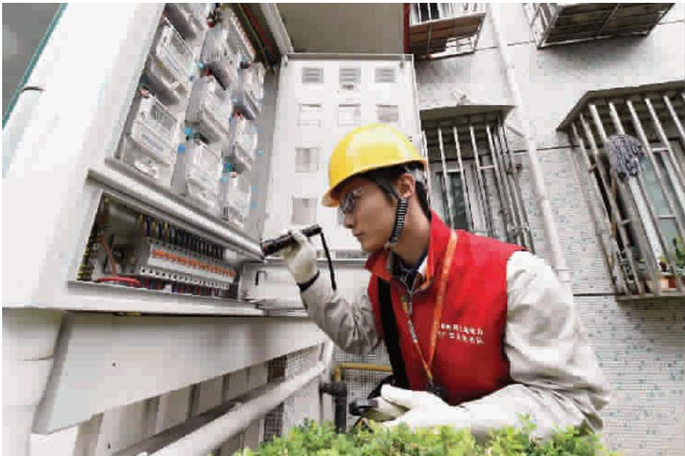
电力工作人员检查改造后的设备
