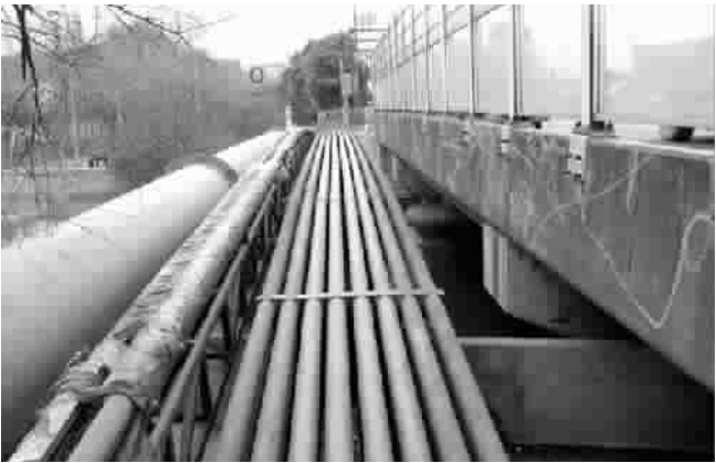
■ 路人爬管道过河险象环生 陈浩 摄
