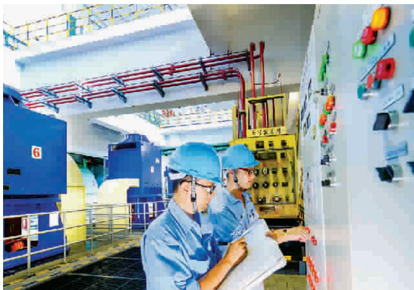
■ 彭越浦泵站的技术员正对8台大马力泵机作例行检查
