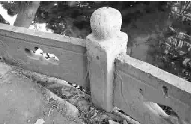
■ 水泥护栏断裂移位岌岌可危
