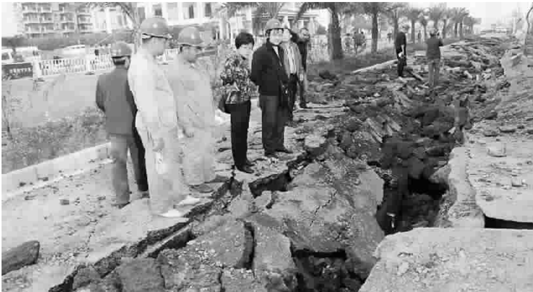
北海市金海岸大道非机动车道爆炸现场
