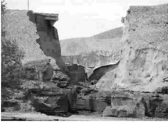
■ 管涌引发坍塌的翻山岭水库部分坝体（5月6日摄） 新华社 发
