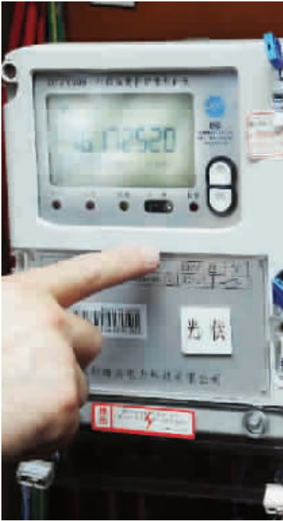
■ 陈家的“光伏双向智能电表”能显示出他输入国家电网多少度电
