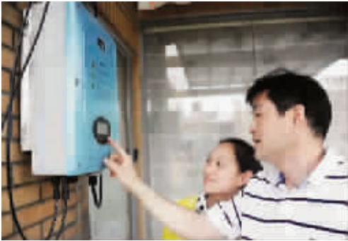
■ 女儿陈祐莹对爸爸安装的光伏发电系统很有兴趣
