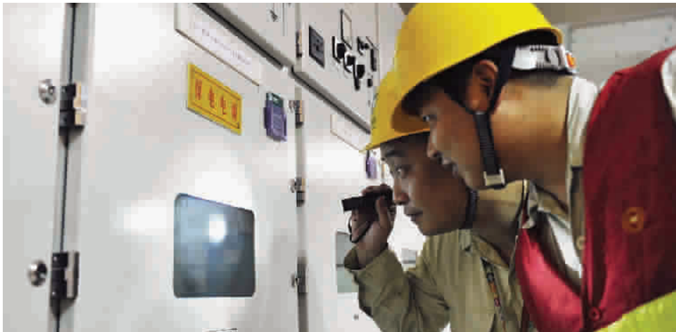
■ 电力职工正在检查电力设施
