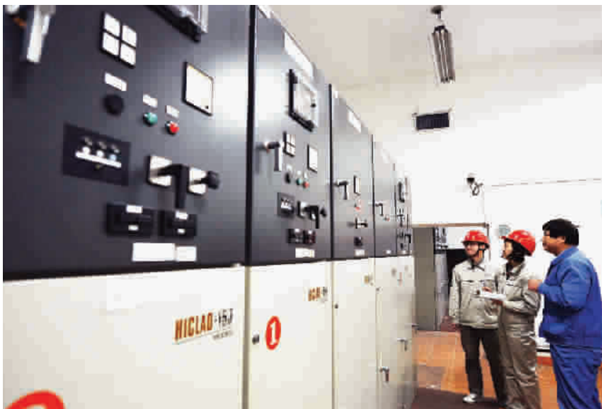
■ 浦东供电公司派员定期为自贸区内企业提供上门维护检查服务
