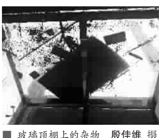
玻璃顶棚上的杂物 殷佳维 摄
