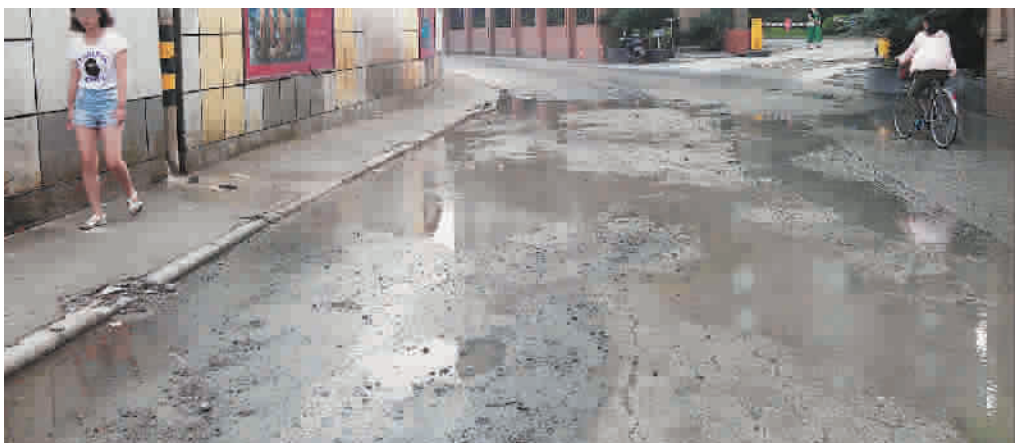
中华新路地面坑洼积水严重 左妍 摄
