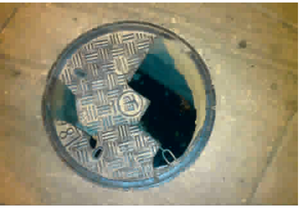
井盖已经只剩下半边 于塘路西侧的非机动车道内,一只窨井
