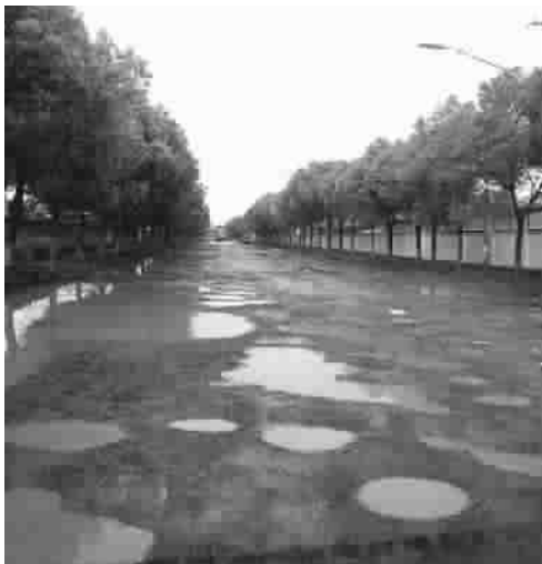
■ 茸北路东段破损严重 李光 摄
