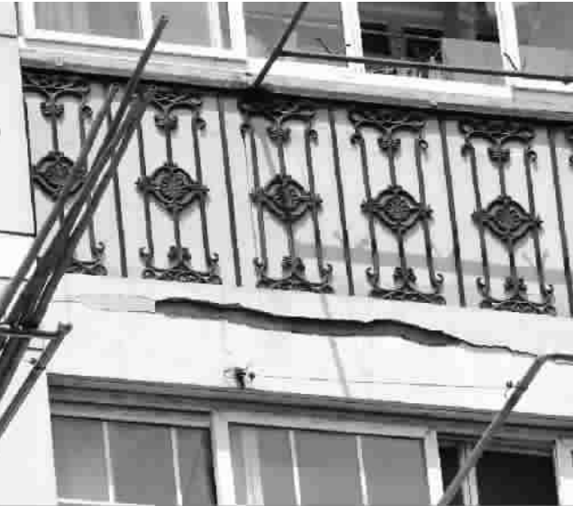
■ 外墙开裂剥落险象环生 读者供图
