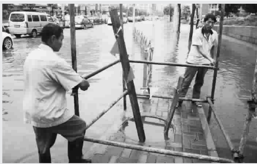
昨天,金沙江路上,一只7米深的窨井缺了井盖,正在附近造桥的一家路桥施工企业派出工人在窨井周边设置临时防护栏,防止路人不慎路入。 杨建正 摄影报道
