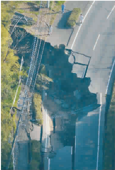
熊本县道路在地震中受损严重
