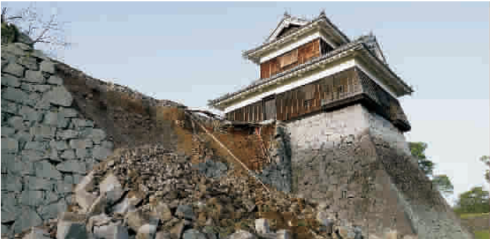
熊本城部分外墙坍塌
