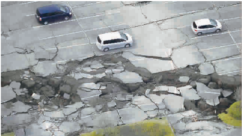
地震导致熊本县一停车场的地面开裂
