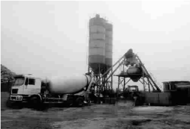
■ 加工厂正在生产劣质建材
