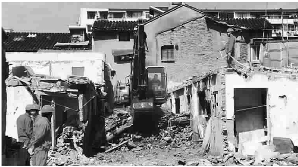
■ 有些房子就像砂石堆,稍一受力,瞬间倒下
