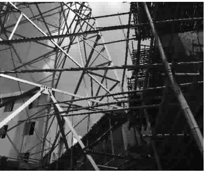
杨高北路违法建筑搭在高压线旁 本报记者 周馨 摄
