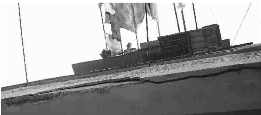
居民家阳台外墙开裂渗水 记者 周馨 摄
