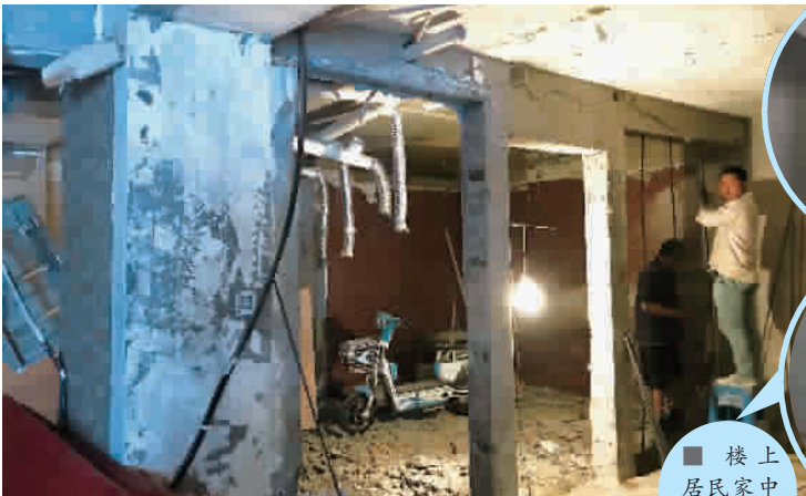
■ 楼下汽配店多面承重墙被切掉
