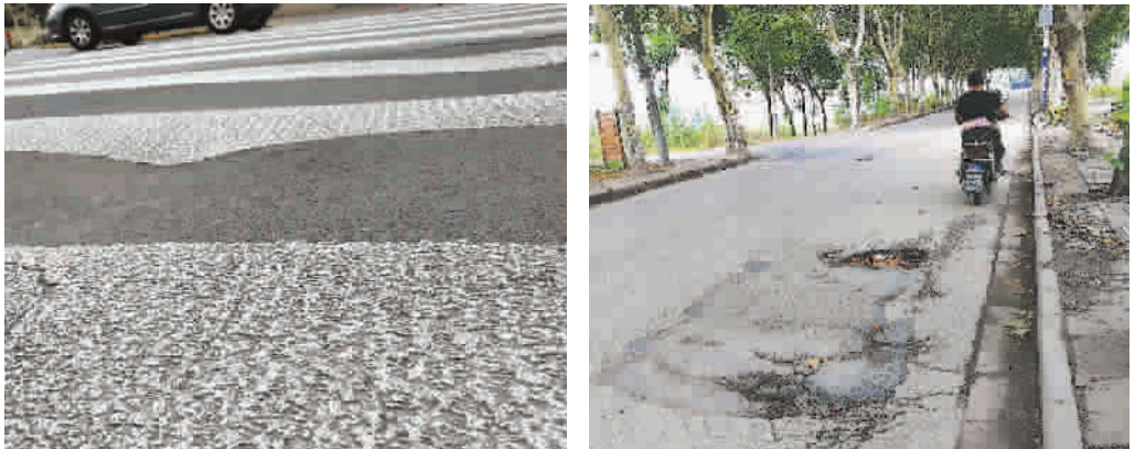
■ 殷行路包头路路口的横道线留有凹坑 ■ 大治河桥下坡路段虽经修补但仍有大坑 罗水元 摄
