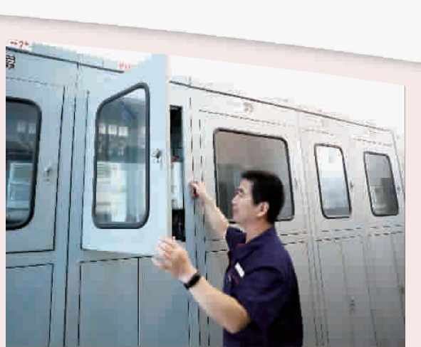
物业人员定期检查设备设施
