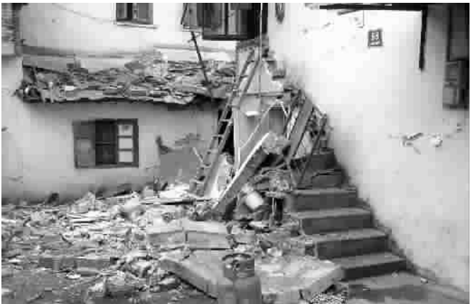
■房屋围墙被炸坍塌
