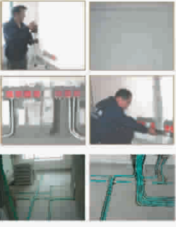
波涛装饰放样现场： 所有项目施工前均须使用专门的仪器按图放样，此步骤能确保精准度，确保精确度，又能减少返工现象。 波涛装饰放样验收： 通过放样后，所有线条高度必须在同一水平线上，且需会使用专门的仪器逐一检验验收。 上海波涛装饰集团： 总部地址：徐汇区中山西路2331号 咨询热线：800-8207-951 波涛网站：www.shibotao.net
