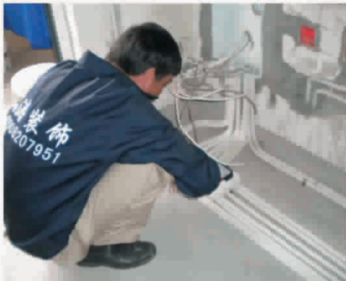
图为监理正在使用万用表进行电力检查，看电源通电情况，看供电是否正常。
