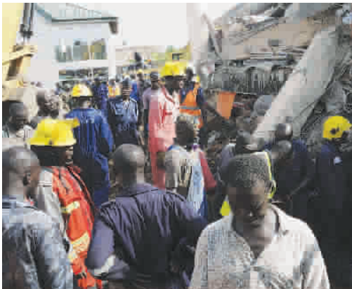
■ 救援人员在商场坍塌现场工作 新华社发
