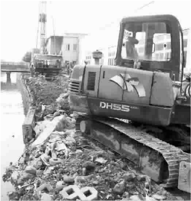
■ 挖土机停靠处，河岸变形泥石被挤压入河
