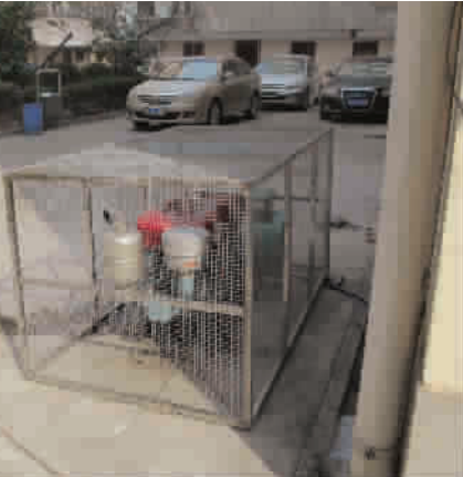
■ 发电机就放在住宅楼墙外地上 金旻矣 摄
