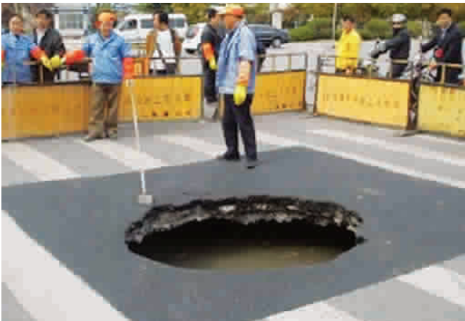
■ 洞内有大量积水，已看不到路基
