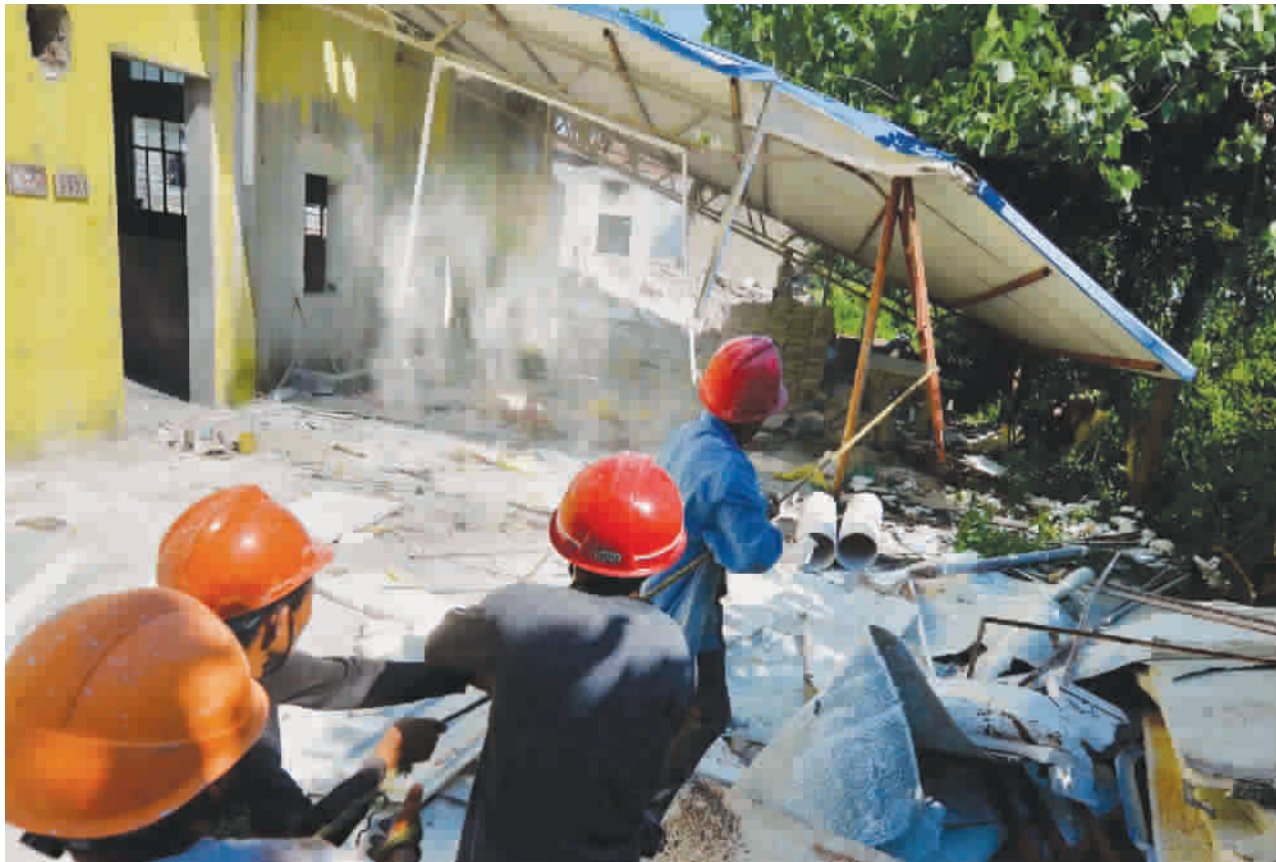
■ 上午接到夏令热线读者张先生投诉后,责任单位立即派员前往闵行区浦江镇新风村现场拆违
