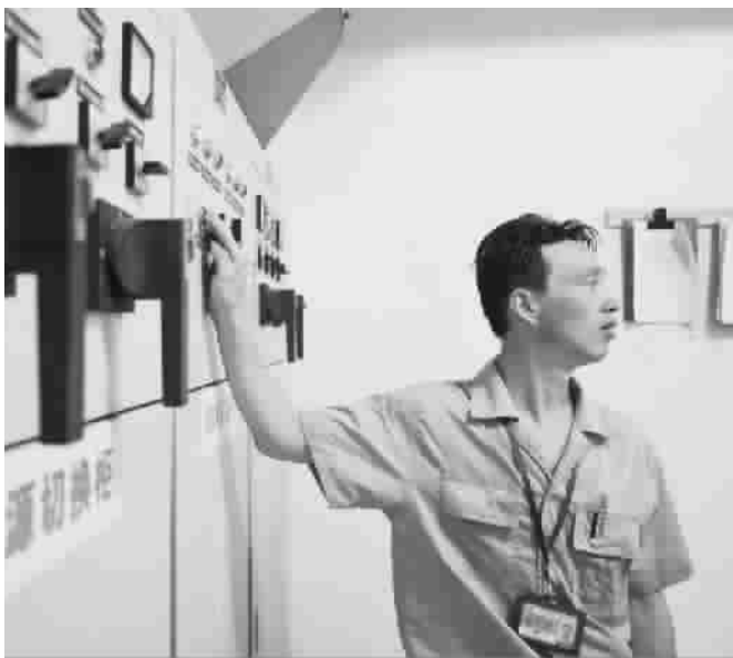
■ 物业工作人员正在检查一小区内的消防泵 本报记者 陈梦泽 摄
