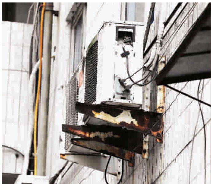
■ 空调外机支架老旧生锈埋下隐患 图 CFP
