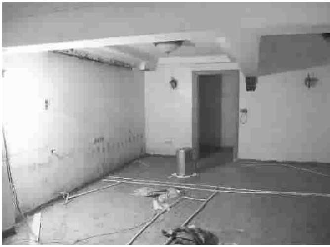
为了寻找渗水点，屋主不得不撬开所有地砖 屠仕超 摄
