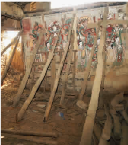
■ 晋城市沁水县石室村西庙内，一堵有壁画的山墙几近倒塌 唐大华 摄
